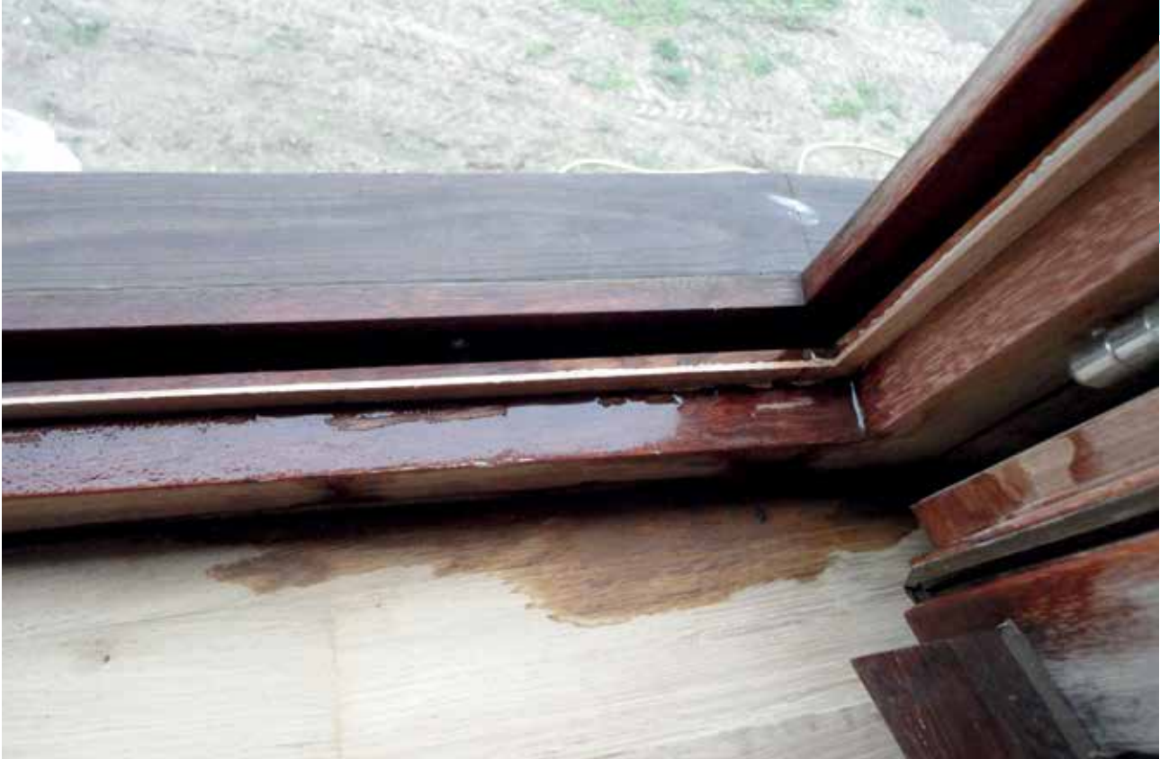
Fig 1: L'étanchéité à l'eau des menuiseries en bois sans traitement de finition n'est pas toujours garantie.
